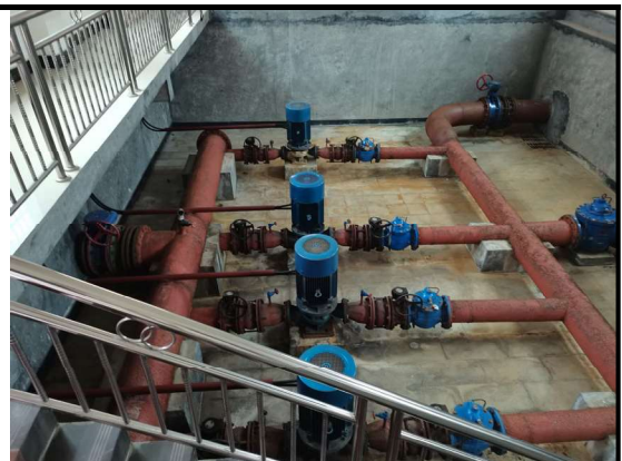
现有工程水泵
