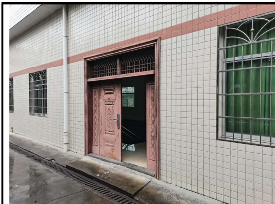
现有工程水泵房
