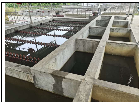
现有工程沉淀池
